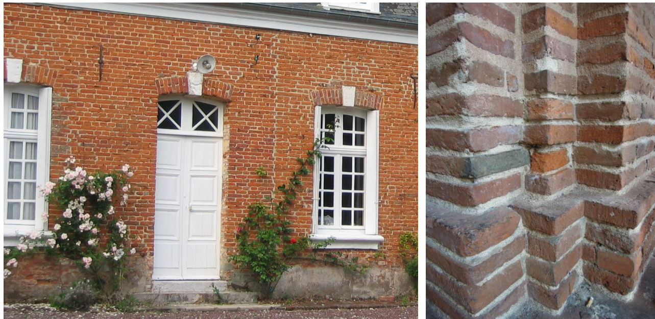
A gauche : Construction en brique du nord de la France / A droite : construction en brique foraine
